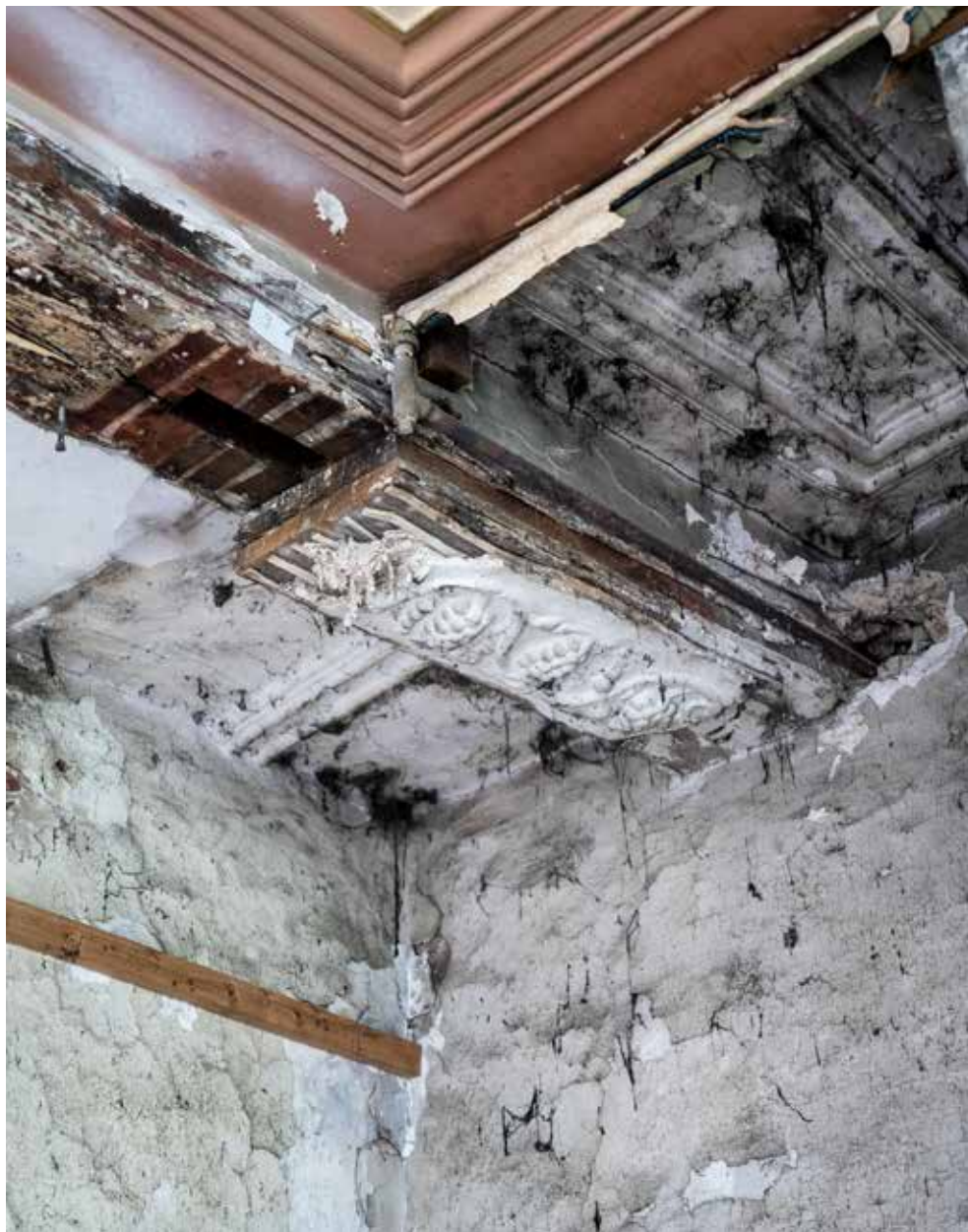
→ Restant van vroegere afwerking van een plafond in een kamer op de gelijkvloerse verdieping, ontdekt tijdens de huidige verbouwingswerken
